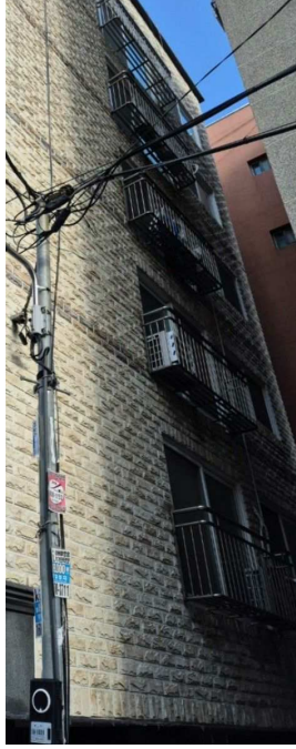
본 건물 남측면 창호 외부 설치 낙하방지틀 모습
