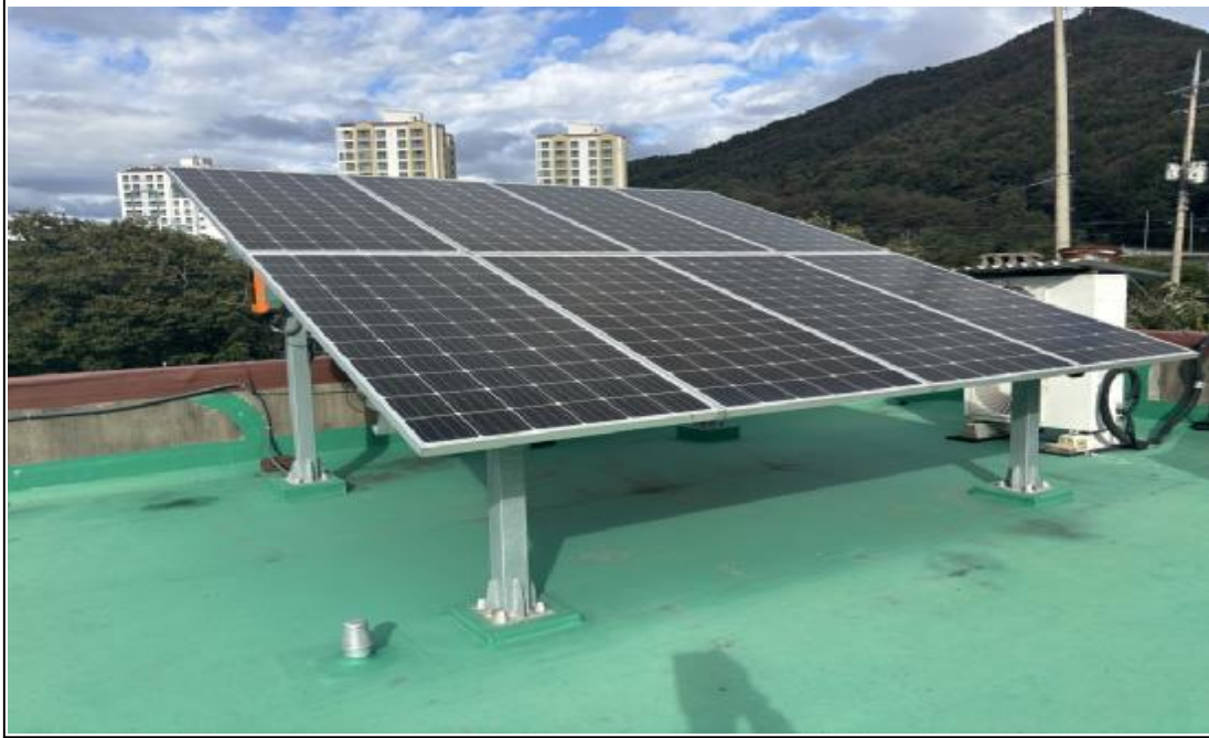
기호(2) 지붕 위 소재 타인소유 태양광설비
