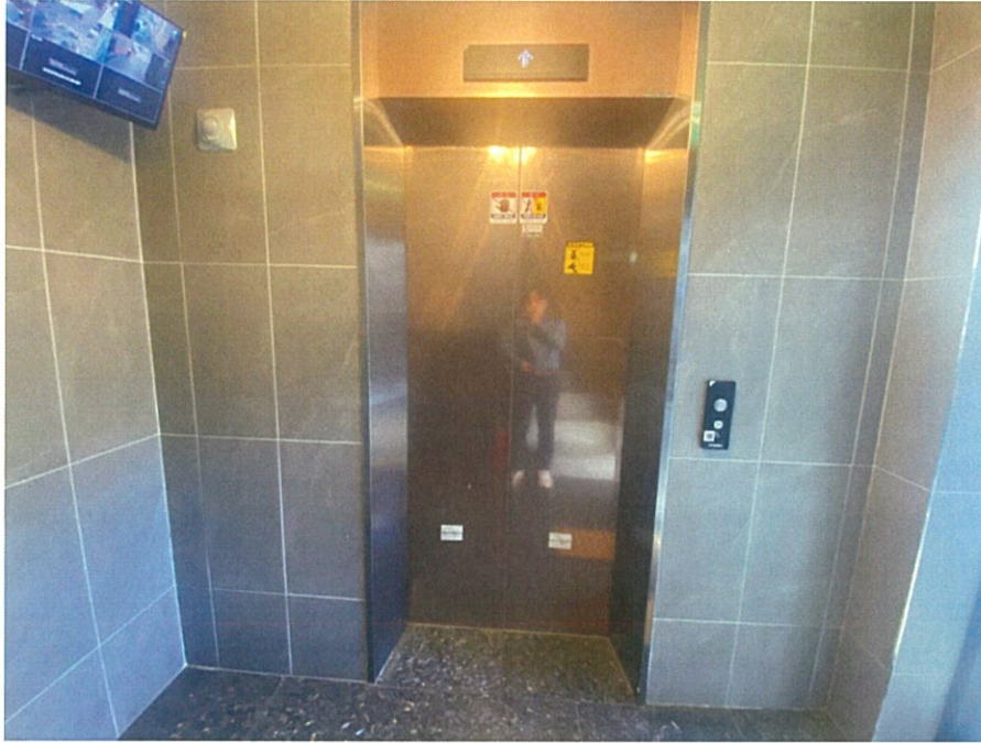
본건 소재 건물 승강기 설비
