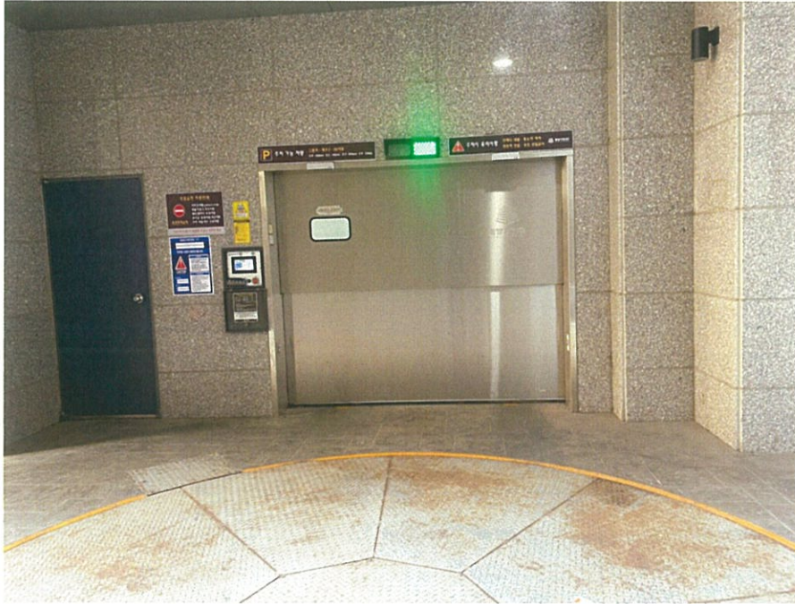
본건 소재 건물 기계식 주차장 설비
