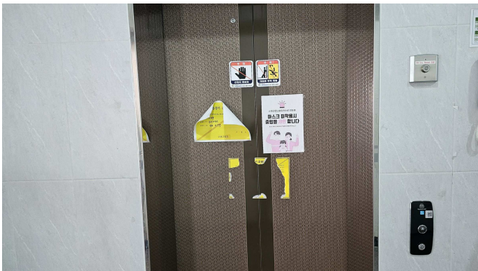
< 운행 정지 상태인 승강기 전경 >
