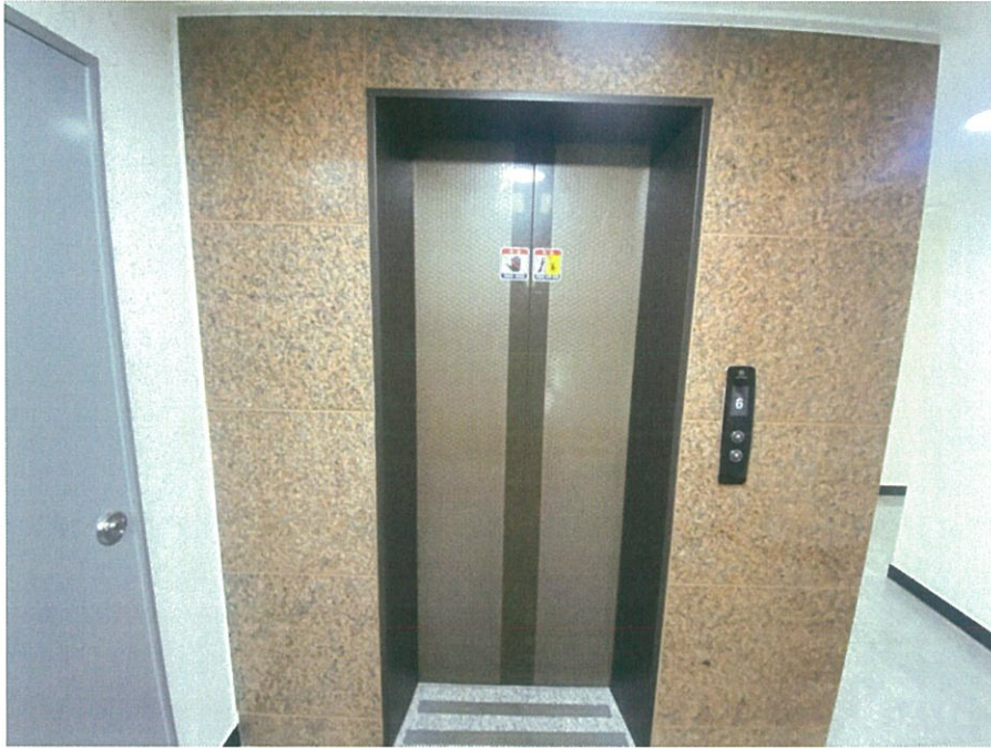
본건 소재 건물 승강기 설비
