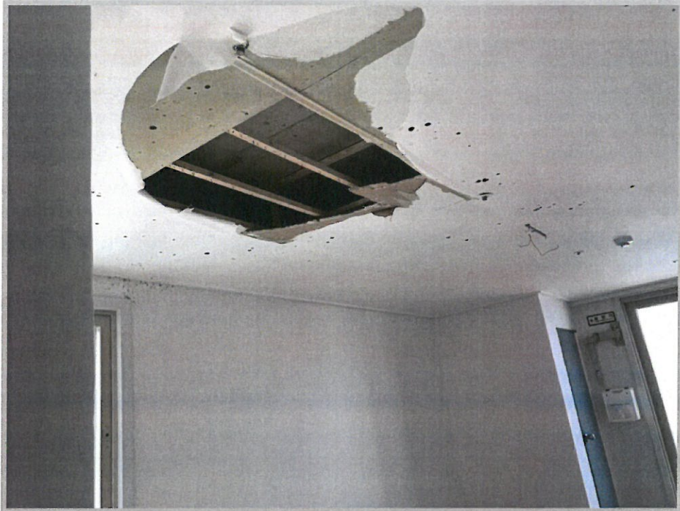
[기호(57) 천장 일부 파손 사진]
