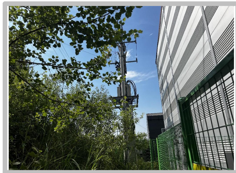
【 제시외 수변전설비 ㉞ 전경 】
