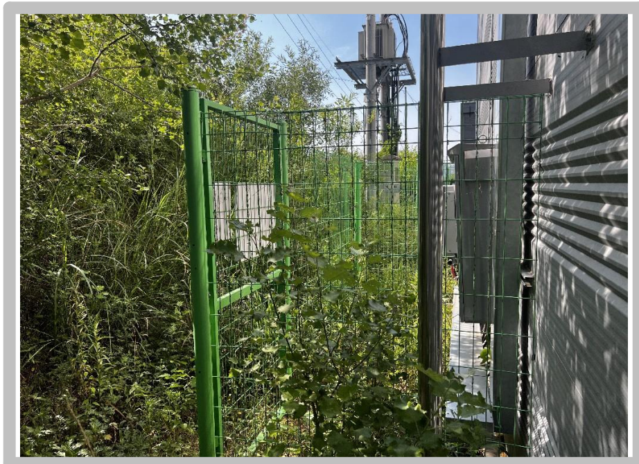
【 타인소유 태양광발전설비 전경 】
