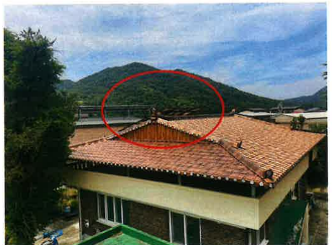
타인소유 태양광 발전설비
