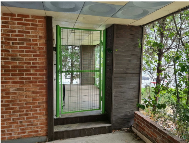
1층 소재 공부상 자전거보관소, 현황 목재 데크
