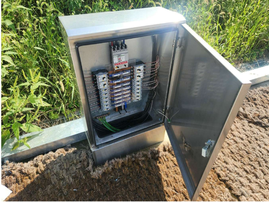
기호(2) 내 철거가능 사우나시설(옥외 분전반)
