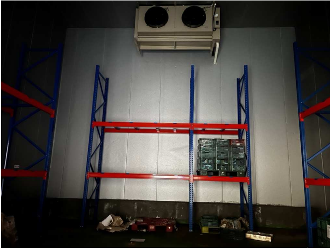
기호2 건물 1층 냉동 창고
