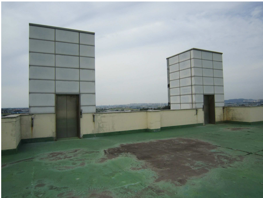
본건 기호 1 건물 승강기설비
