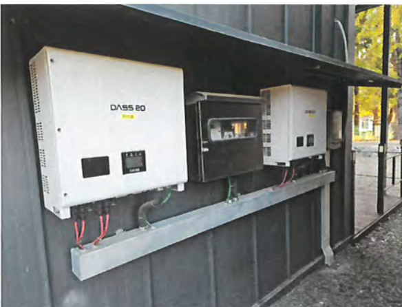
본건 기호(3) 태양광설비(인버터)
