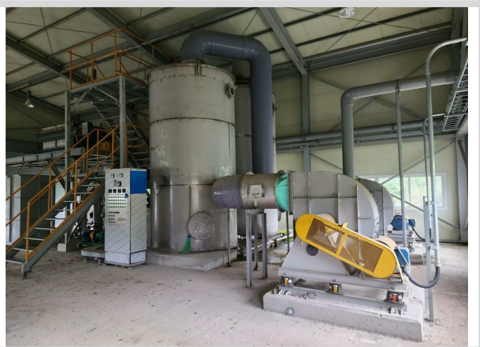
기계기구 지상부분 내 전경 1
