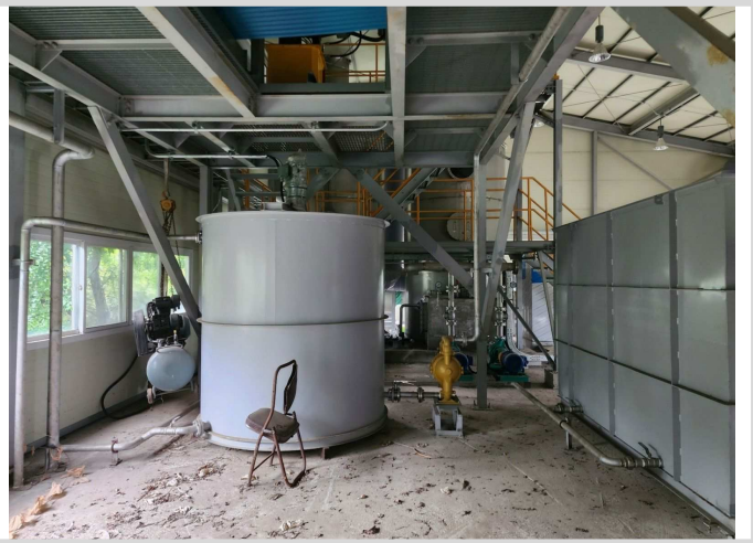
기계기구 지상부분 내 전경 3
