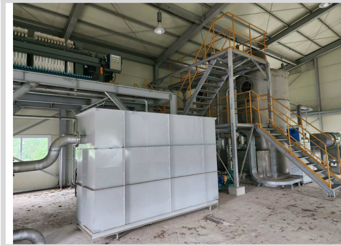
기계기구 지상부분 내 전경 2
