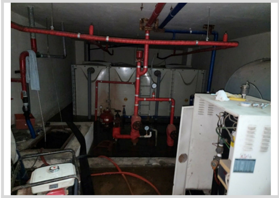
기호(4)지하1층 내부(펌프 및 물탱크실) 전경
