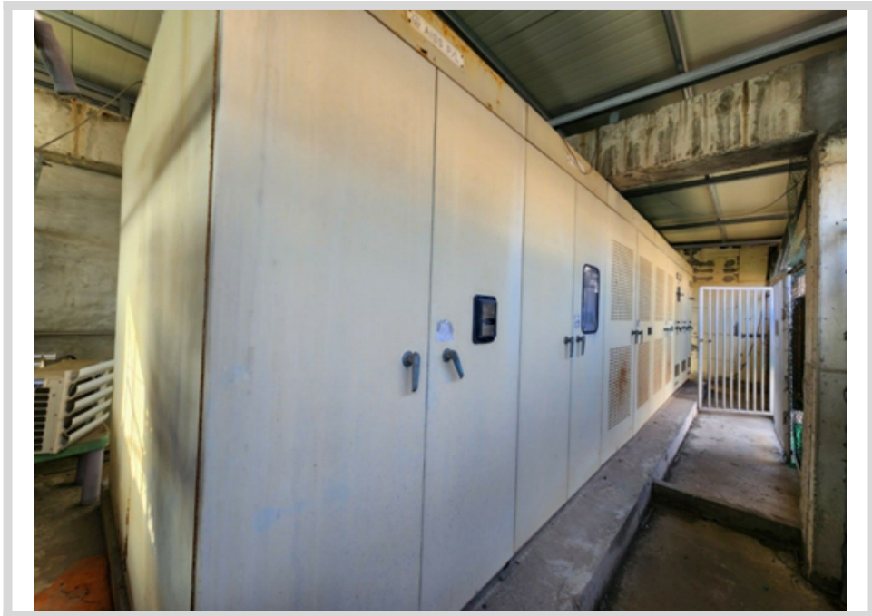
제시외(ㄷ) 내부 소재 '수변전설비' 전경
