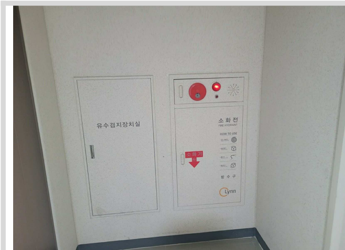
건물동 내 소화시설 전경
