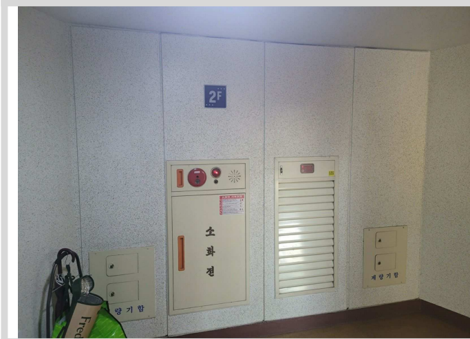
건물동 내 소화전설비 전경
