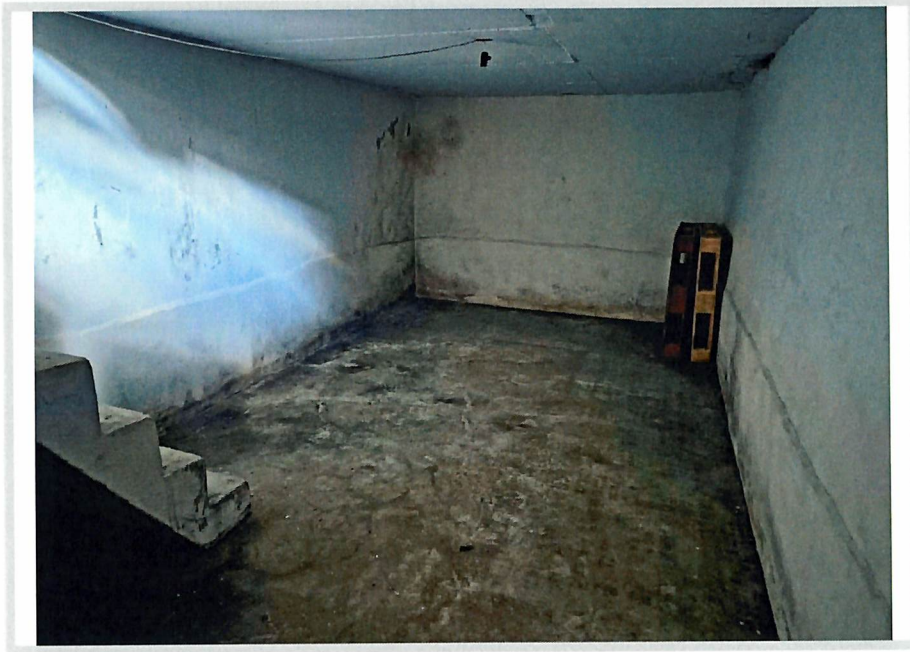
기호(3) 건물 소재 반지하 창고 내부
