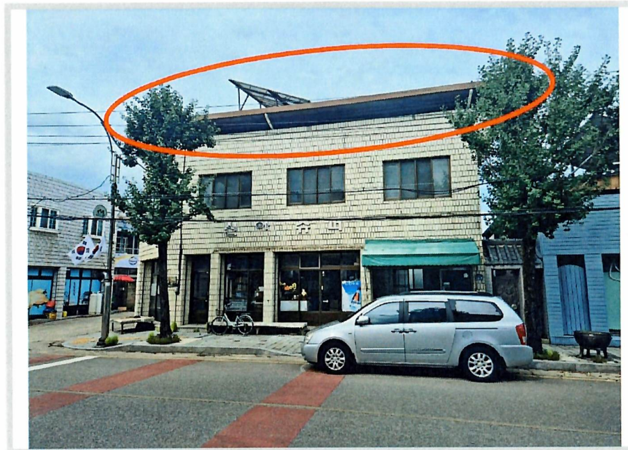
비가림시설 및 태양광 발전 설비
