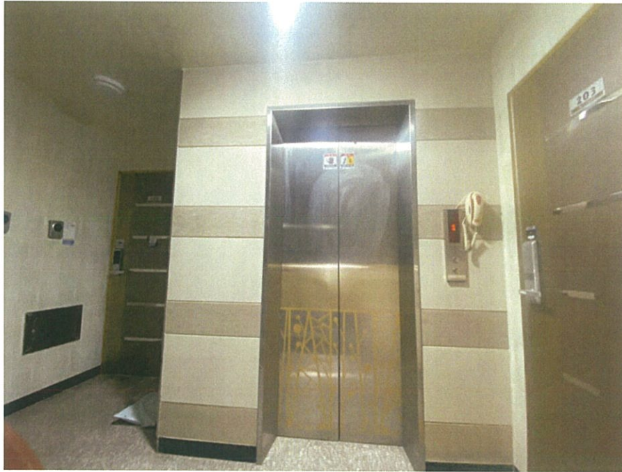
본건 소재 건물 승강기설비
