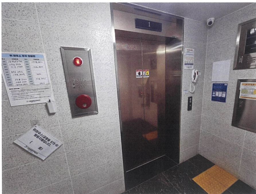
본건 소재 건물 승강기설비
