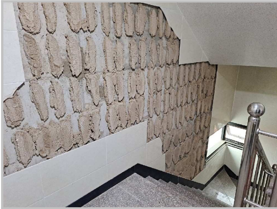
[본건 계단실 내벽 파손부분]
