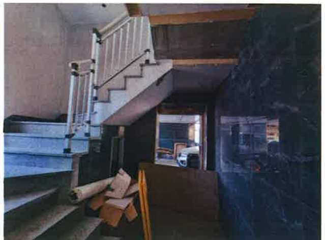
1층(공동출입구 자동문 미시공)
