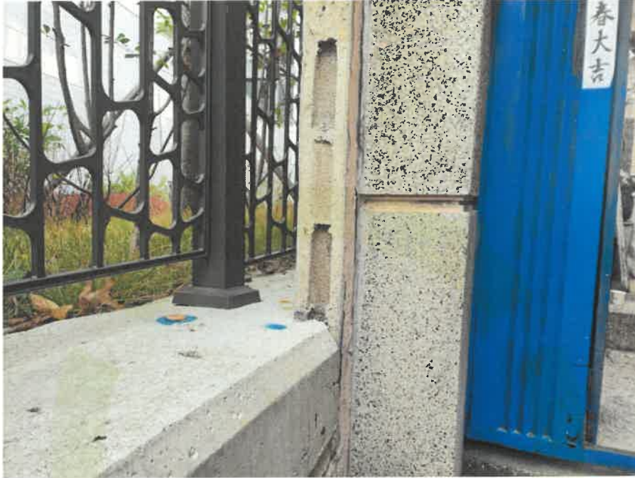
정비구역 지정선의 옹벽 및 휨스전경
