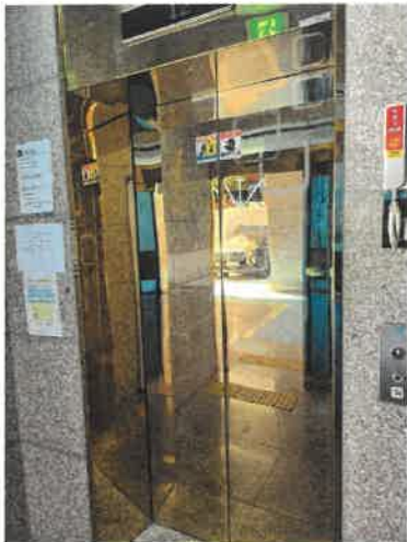
1층 공동엘레베이터 전경
