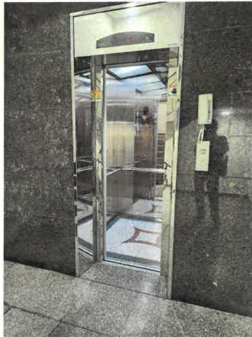
각층 공동 엘리베이터 전경
