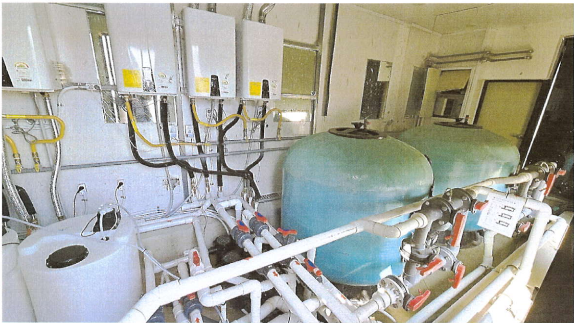
제시의 구축물 수영장 설비 사진
