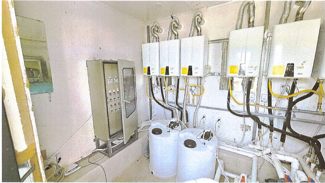
제시의 구축물 수영장 설비 사진
