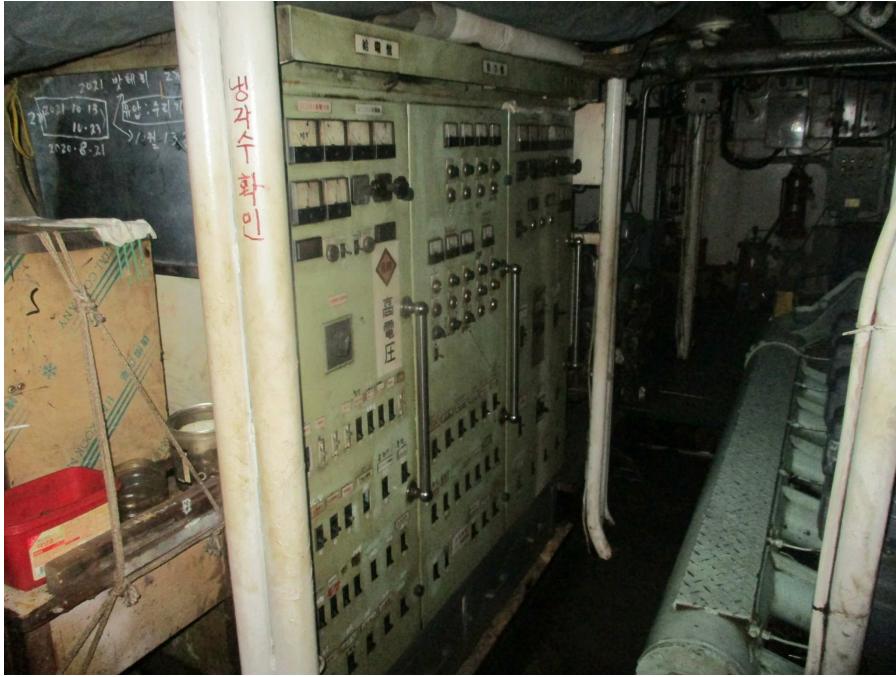
의장품 기호② Main Switch Board
