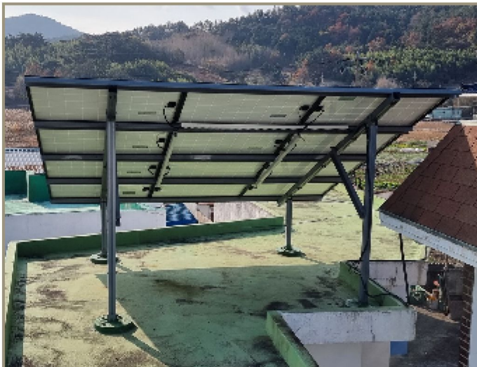
기호(7) 가정용 태양광 발전설비 일부 전경
