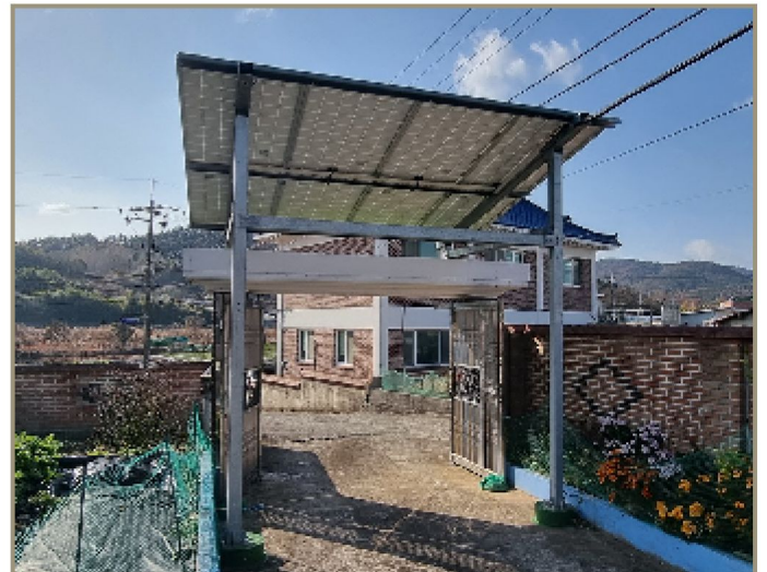
기호(7) 가정용 태양광 발전설비 일부 전경
