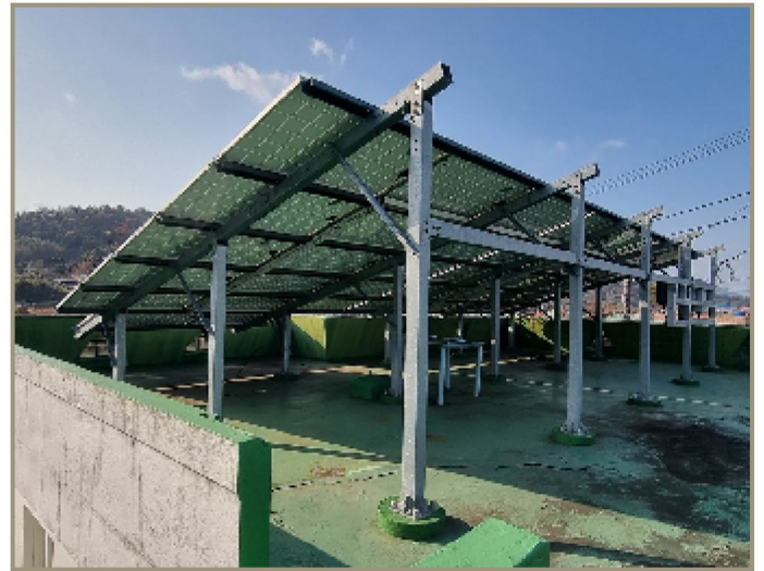
기호(7) 가정용 태양광 발전설비 일부 전경
