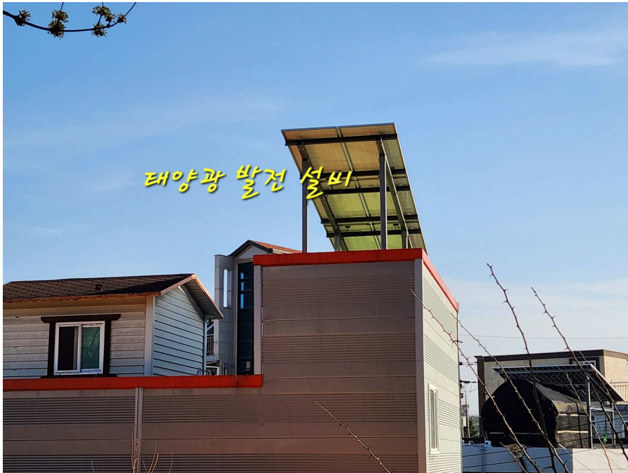
태양광설비 [Module 8ea, Inverter, Cap약`2,000-3,000w] 건물에 포함하여 평가하였음.
