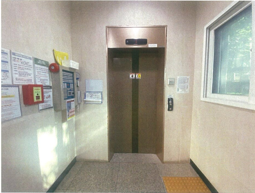
본건 소재 건물 승강기 설비
