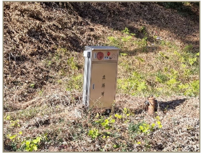
일련번호(3) 일부 지상 소화전설비 전경
