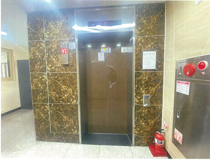
본건 소재 건물 승강기 설비
