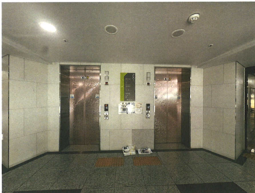
본건 소재 건물 승강기설비
