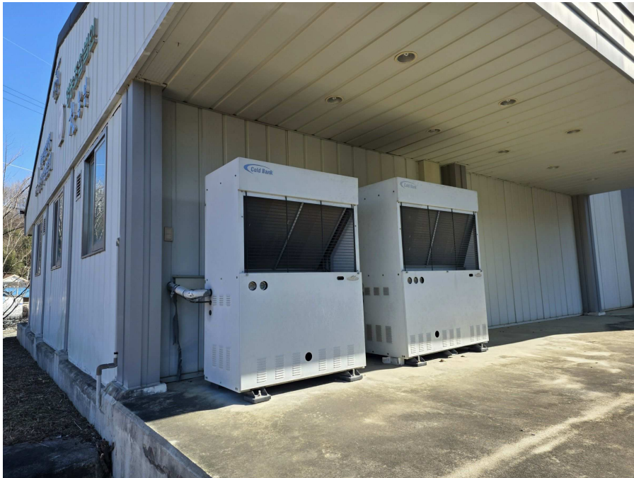
제시외 물건 (기호c) CONDENSING UNIT ; MODEL SCU-PS100L-SASB33 등
