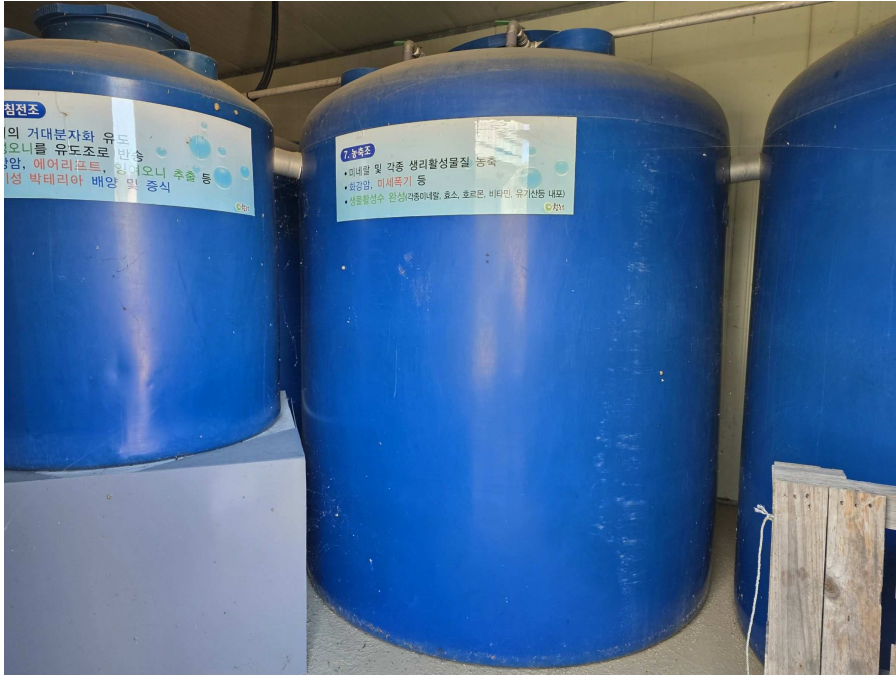
제시외 물건 (기호b) 내부 오폐수처리설비, 경량철골구조 판넬지붕 및 처리구조물 Cap`3 ton, 발생량1.3t 규모, 내부 처리탱크 등
