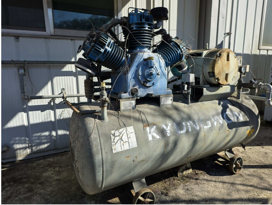
제시외 물건 (기호c) Compressor ; 15kw 등
