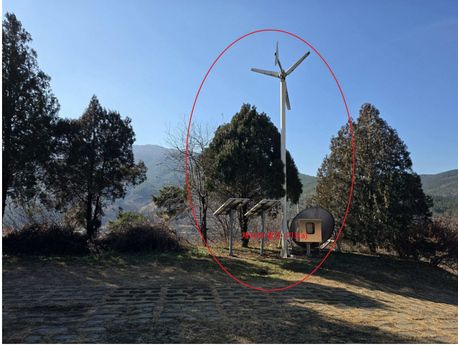
제시외 물건 (기호a ) 가정용풍력발전기, 태양열발전설비, 반사경 등
