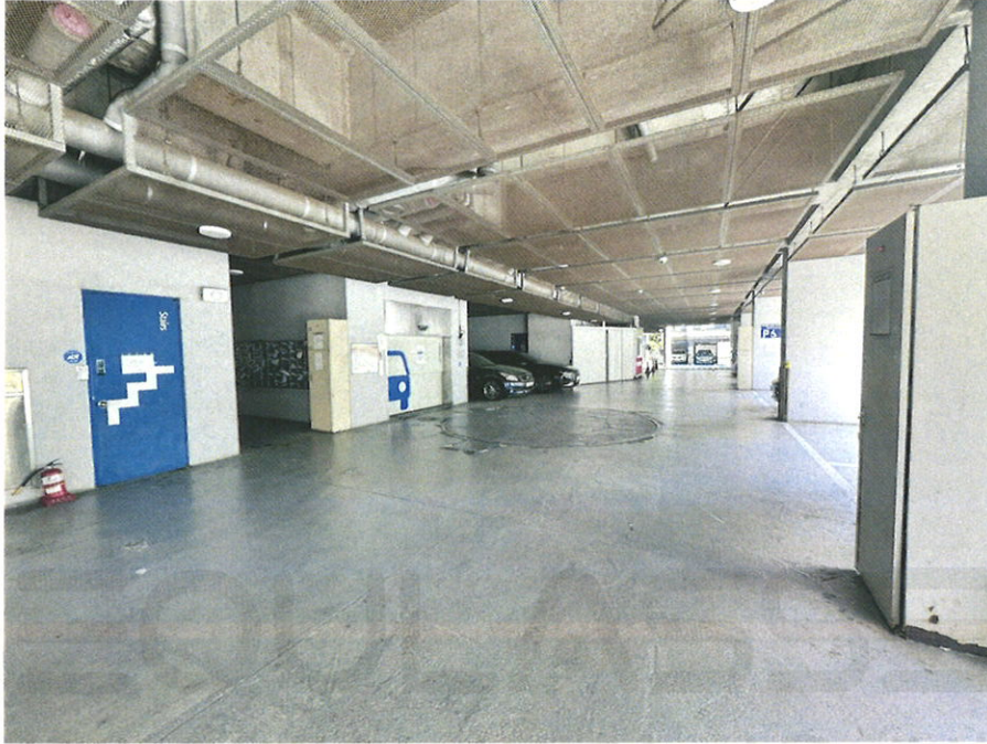
본건 소재 건물 주차장설비
