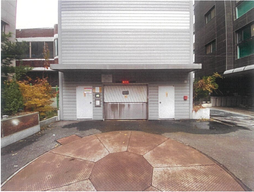
본건 소재 건물 기계식 주차장 설비
