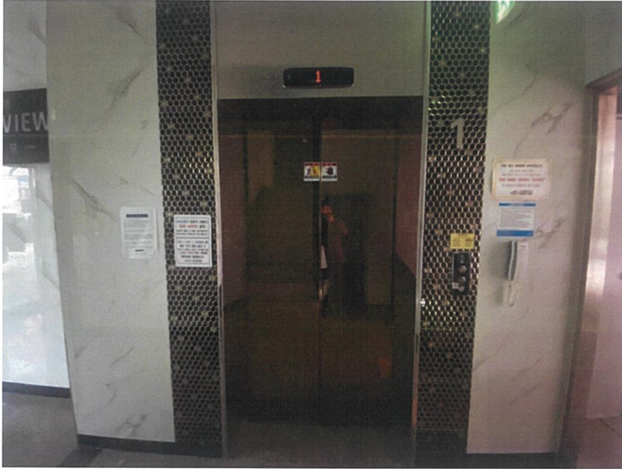
본건 소재 건물 승강기 설비
