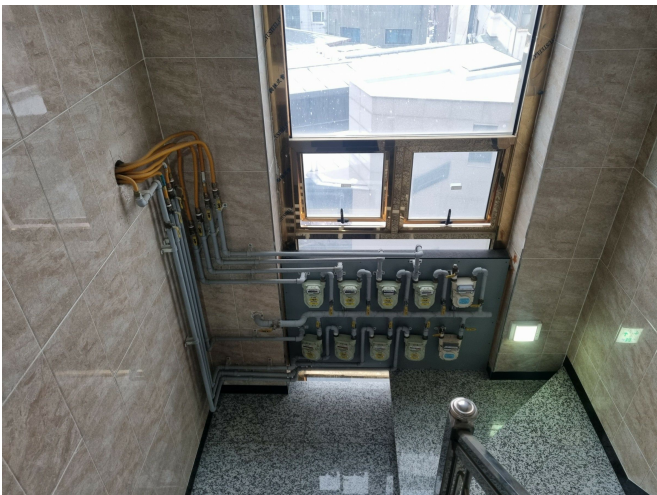
6-7 계단실(6층 도시가스 계량기 및 배관)
