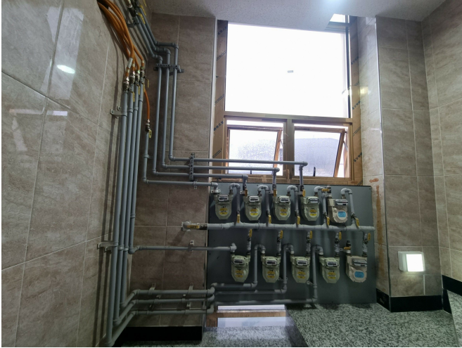
4-5층 계단실(4층 도시가스 계량기 및 배관)
