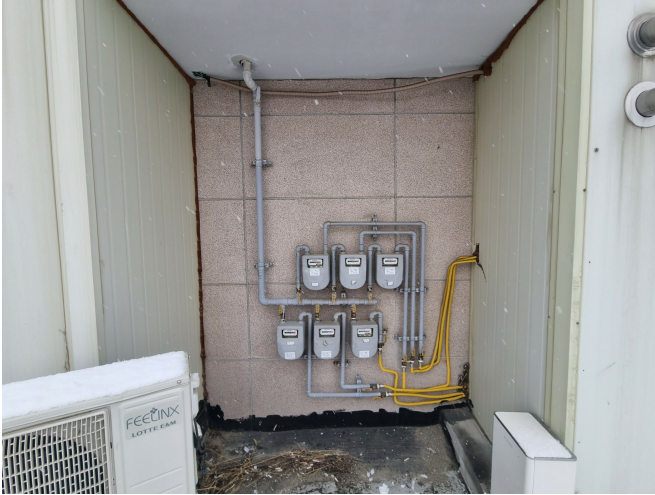
6층 옥상(7층 도시가스 계량기 )
