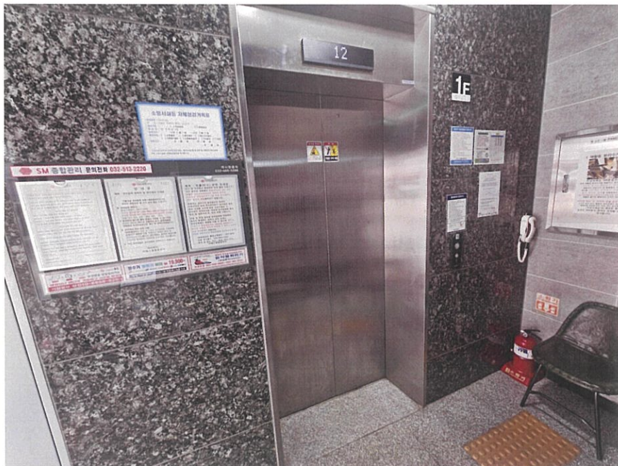
본건 소재 건물 승강기 설비
