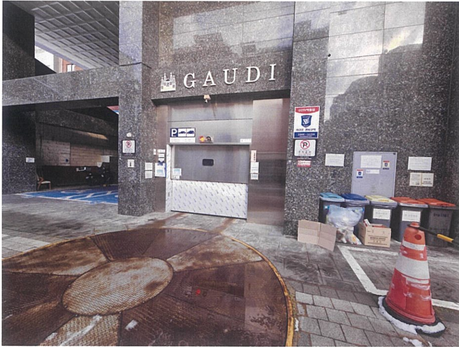
본건 소재 건물 주차장 설비
