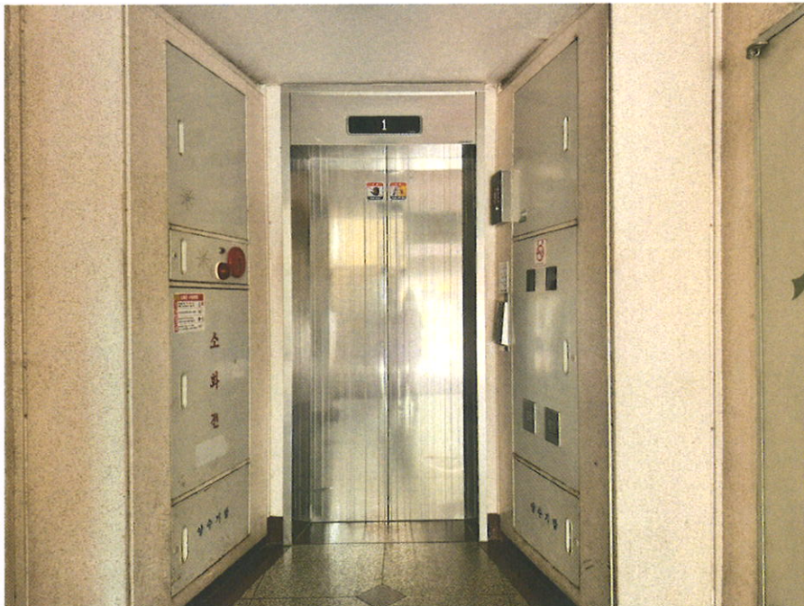
본건 소재 건물 승강기설비
