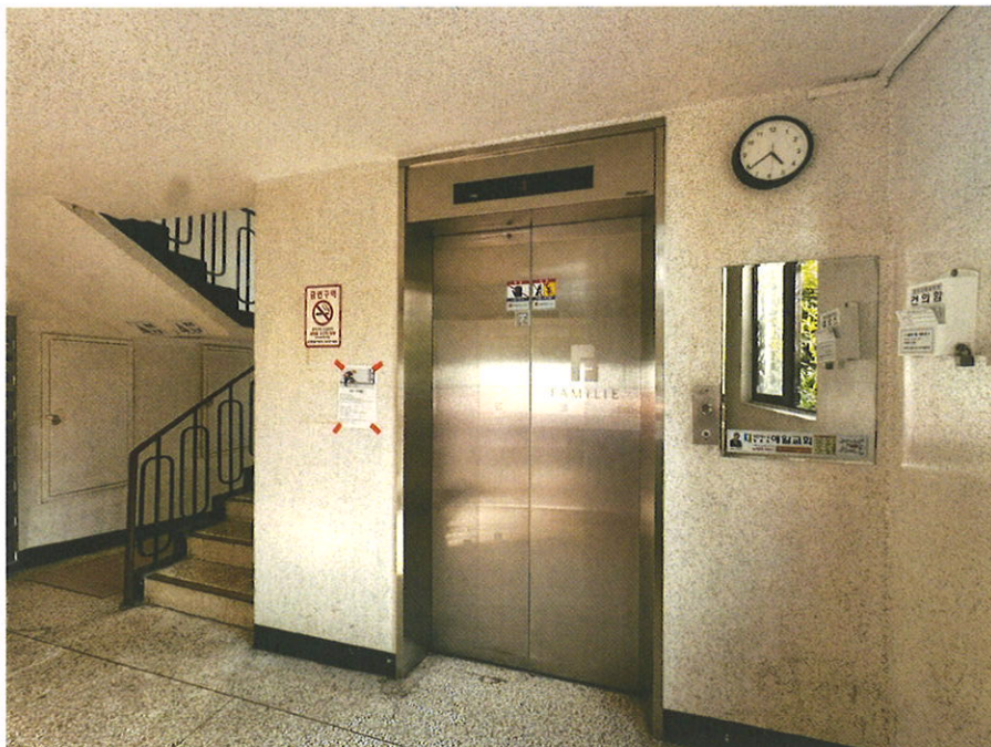
본건 소재 건물 승강기설비
