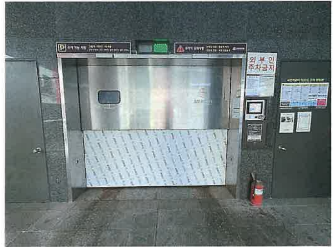
본건 기계식 주차시설
