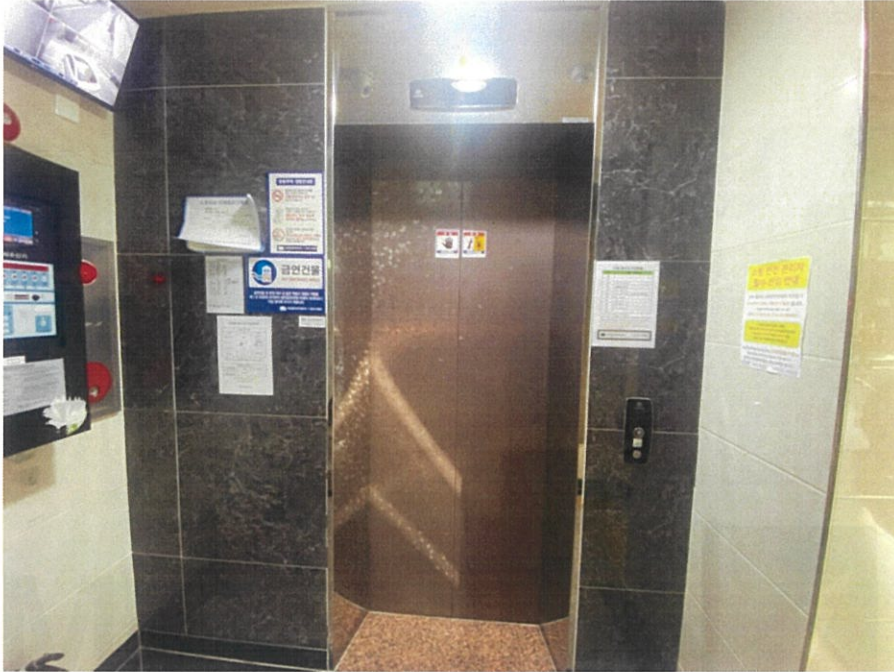
본건 소재 건물 승강기 설비
