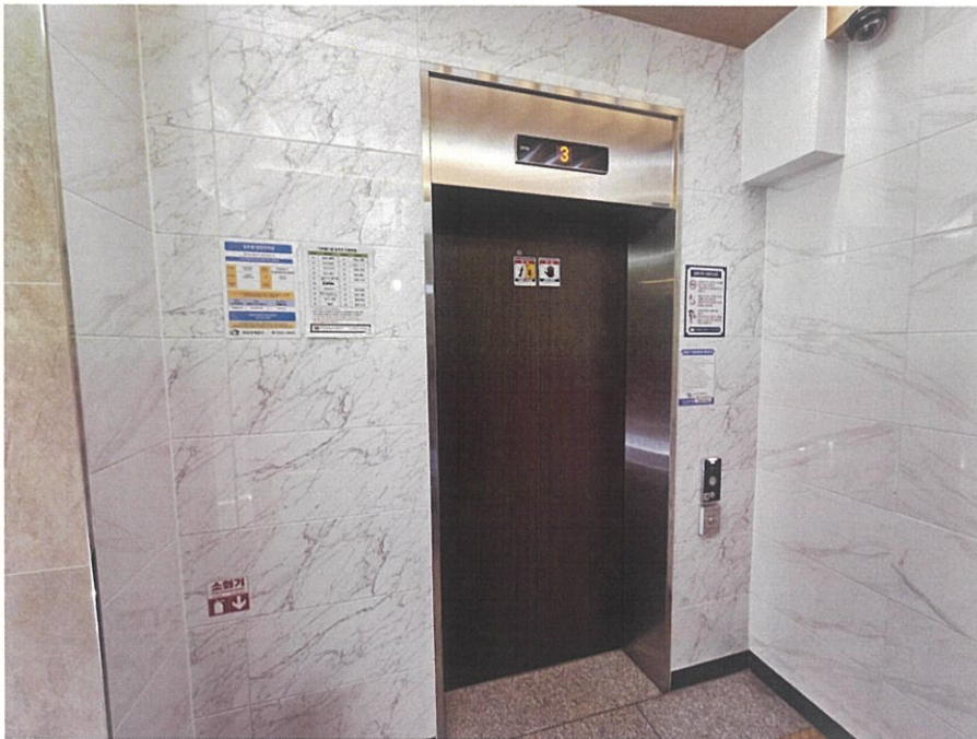
본건 소재 건물 승강기설비
