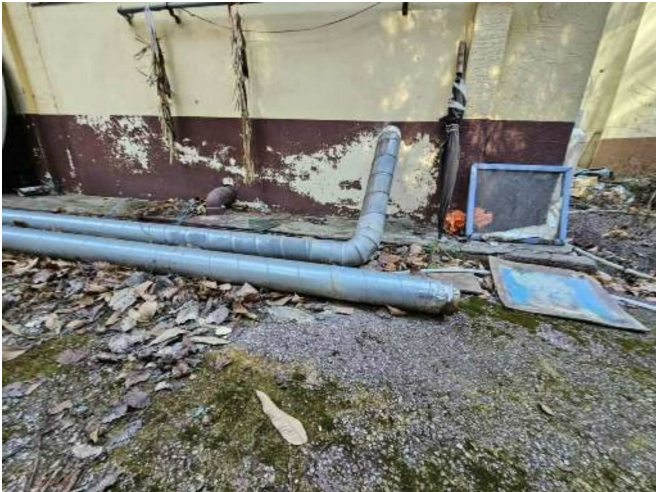
제시외건물 기호 ㊱'외부(내부는 물이 차서 진입이 어려움)
