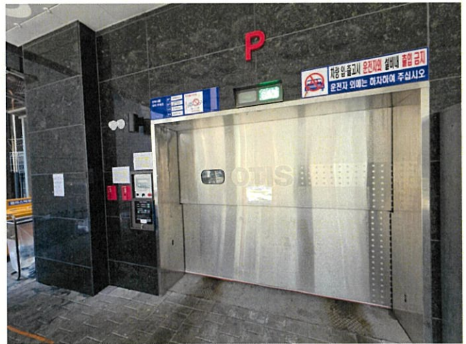
본 건물 기계식주차장 출입구
