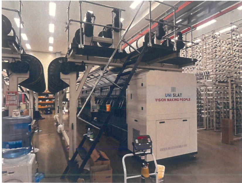
본건 기계기구 일련번호 1 전경
