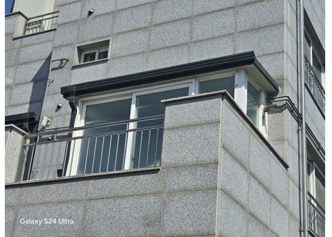
제시외 건물 ㉤ 보일러실
