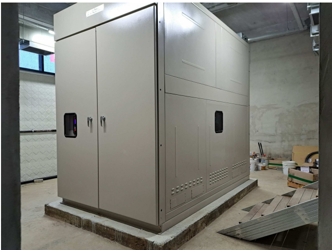
지하1층 전기설비 전경
