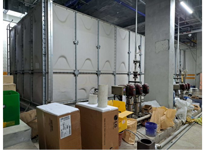
지하1층 물탱크 및 물공급시설 전경
