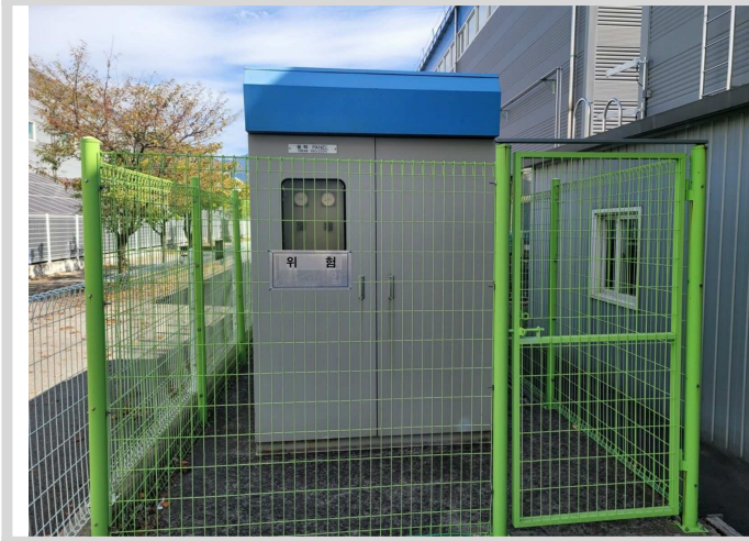
수전설비(건물 부대설비) 전경
