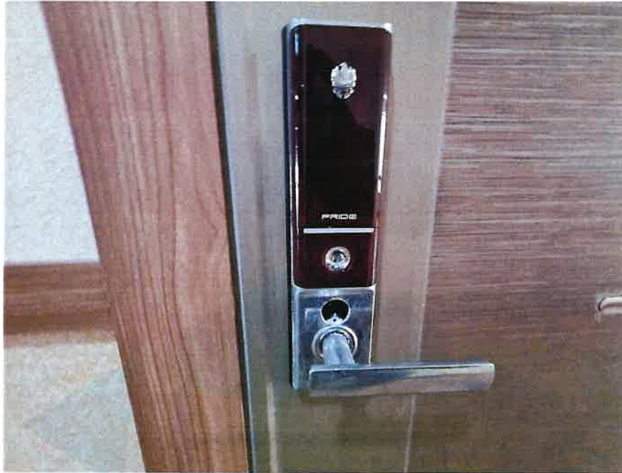
본건 연번(3) 현관문 잠금장치 파손 전경
