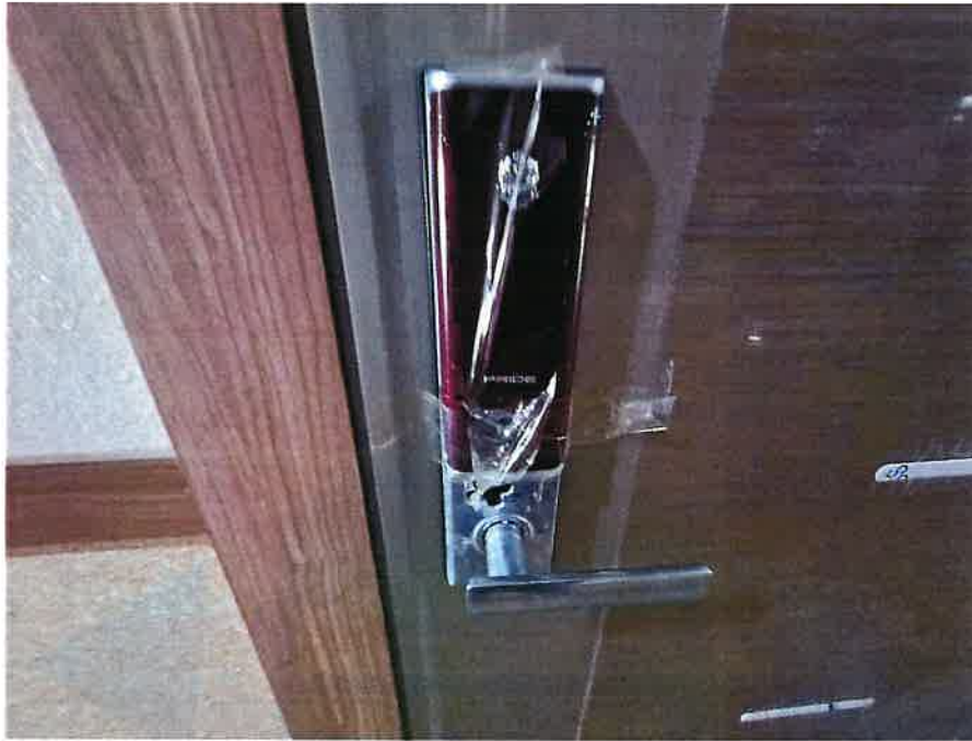
본건 연번(1) 현관문 잠금장치 파손 전경
